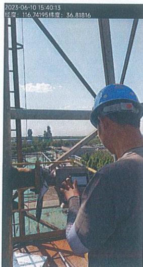
脱硫废液制酸排气筒 (DA062)
